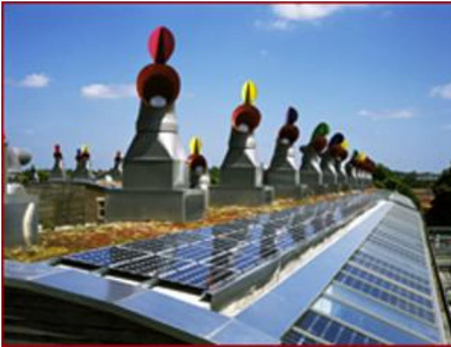
Şekil 3. PV panellerden görünüm [5]
