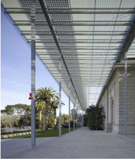
Şekil 4. Yapı saçağında bulunan PV paneller [7]
