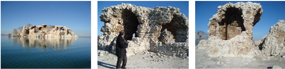
Şekil 7. Beyşehir Gölü içerisinde bulunan Kız kalesinde, atmosferin bozucu etkilerine karşı yeterli önlemler alınmamış, bakımsızlık, ilgisizlik, donma-çözülme etkileri nedeniyle tarihi yapı yok olmaya terk edilmiştir.
