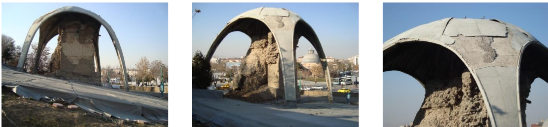
Şekil 2. Kerpiç malzeme üzerindeki betonarme kabuk bakımsızlık, ilgisizlik ve su-nem etkileri nedeniyle bozulmuştur.
