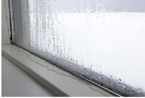
Şekil 3.2 Yağmur sızdıran cam ile çerçeve birleşiminde bozulma [20].
