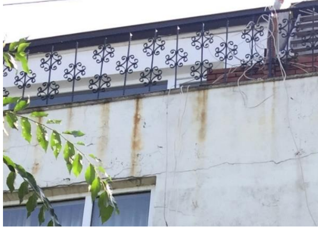
Şekil 3.10 Pasın dış duvarda oluşturduğu kirlenme [2].
