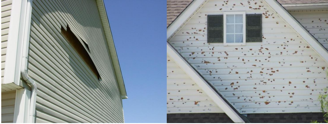
Şekil 2.1 Dış duvar kaplamasında rüzgar etkisi [17] solda, Cephede dolu yağışı etkisiyle kaplamada bozulma örneği [18] sağda.
