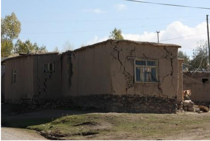
Şekil 3.5 Ekim 2011’de meydana gelen Van Depremi sonrası yığma konut yapısının cephesinde farklı büyüklükte çatlaklar olduğu gözlemlenmiştir [22].
